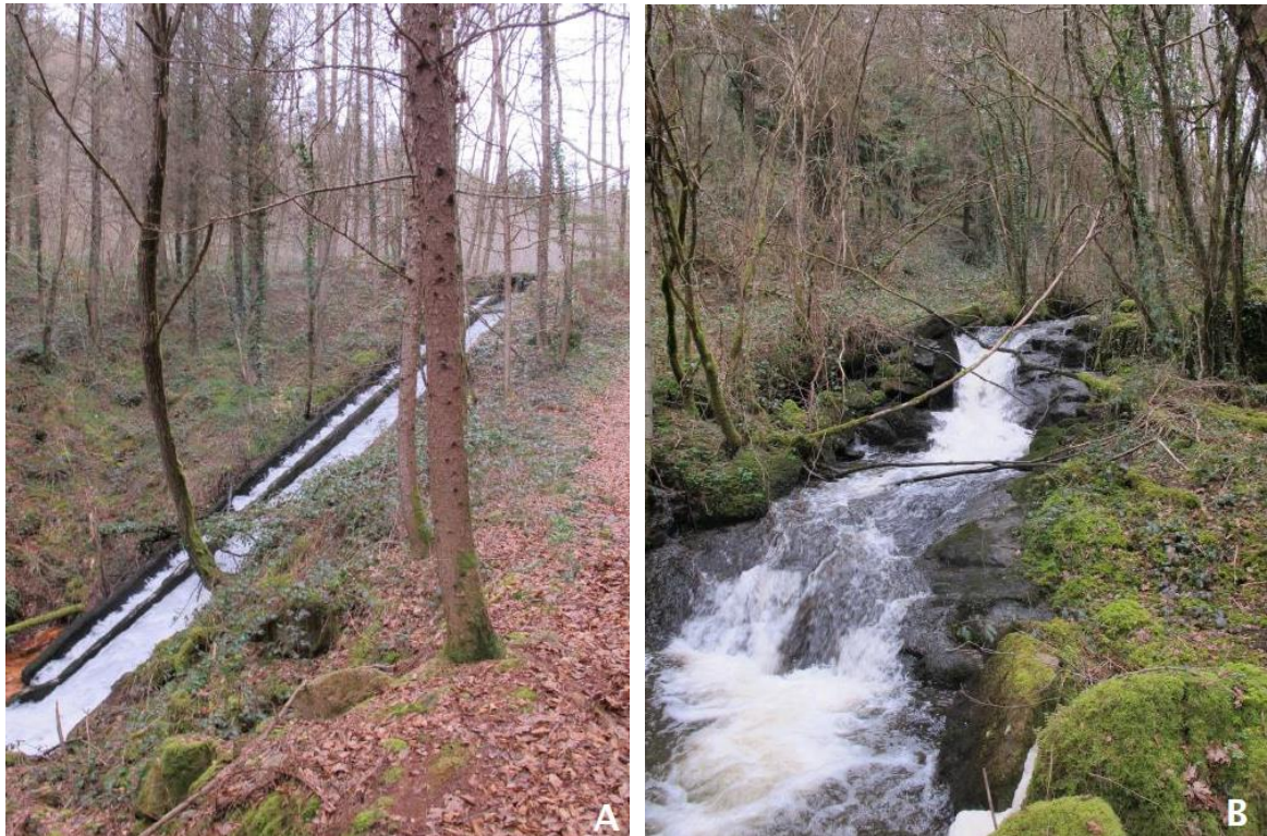
Figure 25 : vues de la rampe en béton (A) et de la fin du tronçon enroché (B)
